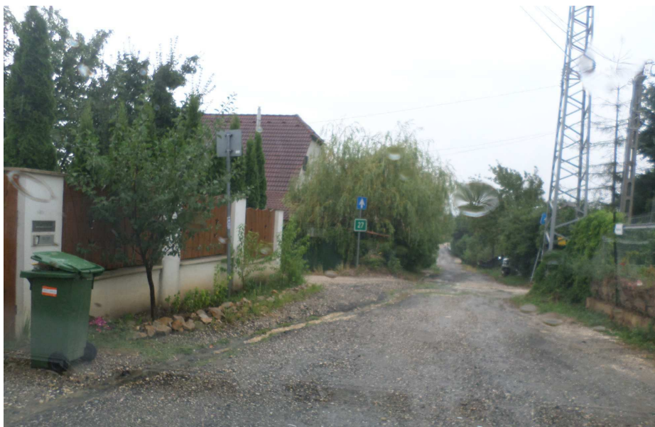
4.1.6.a/ A Mogyoró utca felső szakasza (Erdész utca) a felhőszakadásos időszak utáni állapotban, részben elmosott folyóka, padka, tönkrement útpálya szerkezettel
